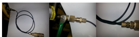
Figura 4. 1 Manguera y conjunto de acoples implementados en la etapa de generación
