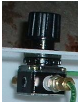
Fig. 6.23. Fotografía regulador de presión
