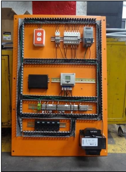
CABLEADOS DE CONTROL
