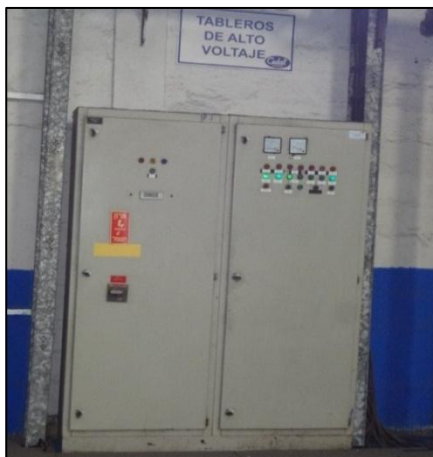
Figura 3. 8: Tablero de alto voltaje
