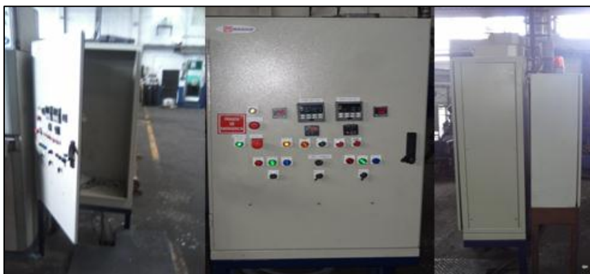
Figura 3. 7: Activación de los controladores de los quemadores.
