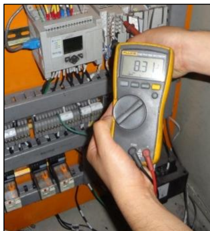
Figura 4. 8: Medición del voltaje en la salida análoga
