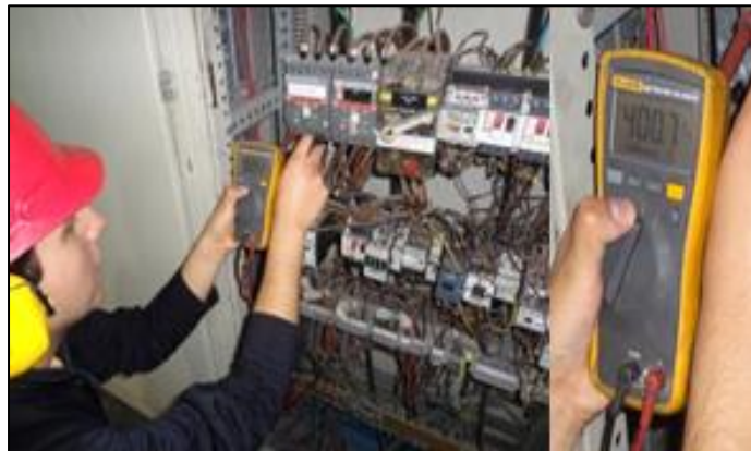
Figura 4. 1: Medición de la alimentación en el breaker de la UPS
