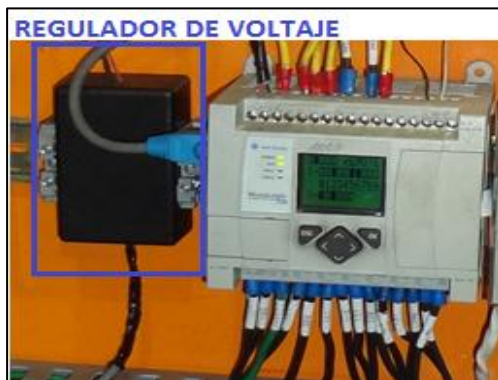
Figura 3. 18: Regulador de voltaje instalado.
