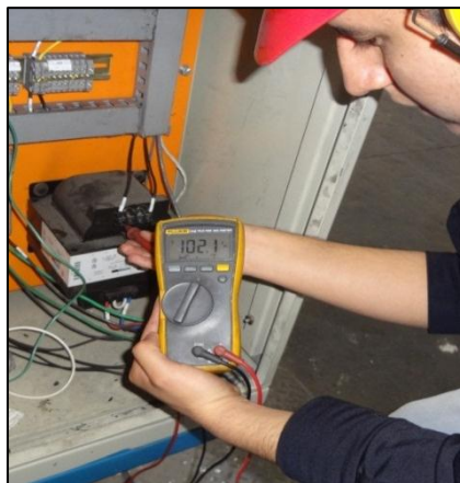
Figura 4. 3: Medición de la alimentación en la salida del transformador
