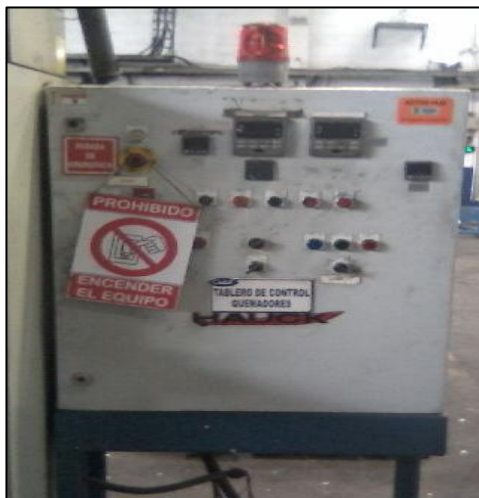
Figura 3. 1: Tablero de control de quemadores.
