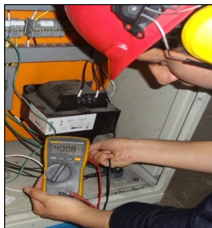
Figura 4. 2: Medición de la alimentación en la entra del transformador
