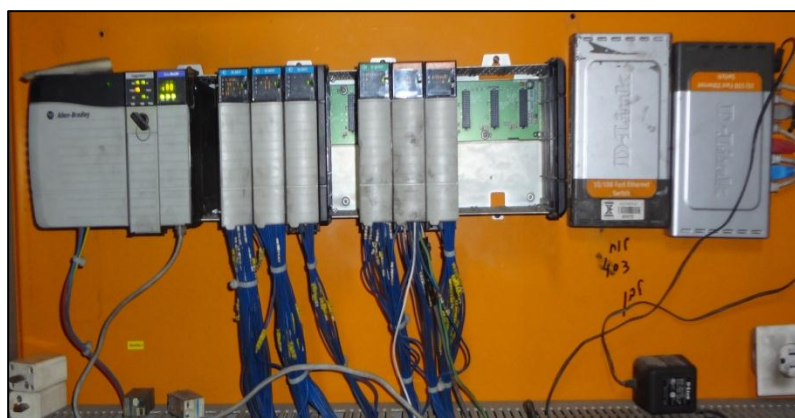
Figura 3. 23: PLC control logix de fundición.
