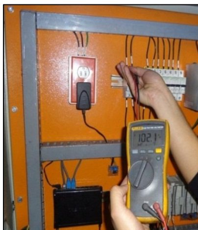
Figura 4. 4: Medición del voltaje de línea en el breaker principal del tablero de control
