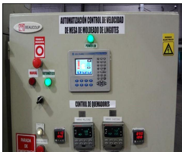
Figura 3. 63: HMI en ejecución.
