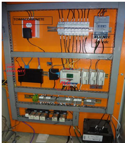
Figura 4. 5: Equipos con alimentación a 120 Vac
