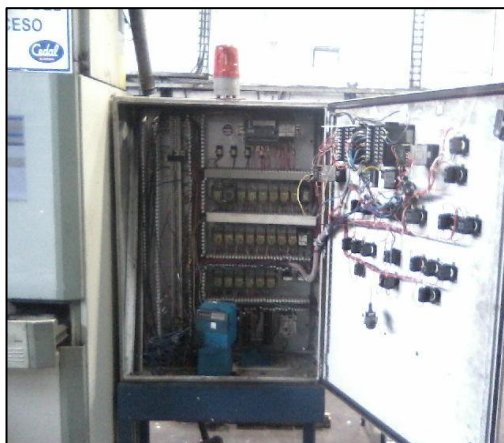
Figura 3. 2: Desconexión de los controladores del tablero de control de quemadores.
