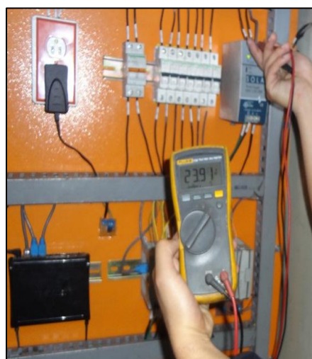
Figura 4. 6: Comprobación del voltaje en la fuente de 24 Vdc
