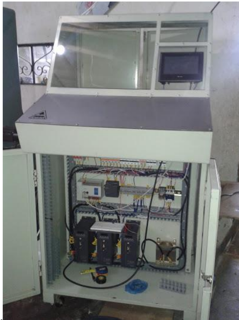
Figura 4-1 Tablero de control de la maquina electroerosionadora.
