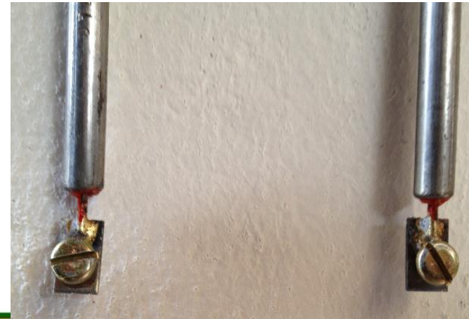
Terminal de conexión utilizado
