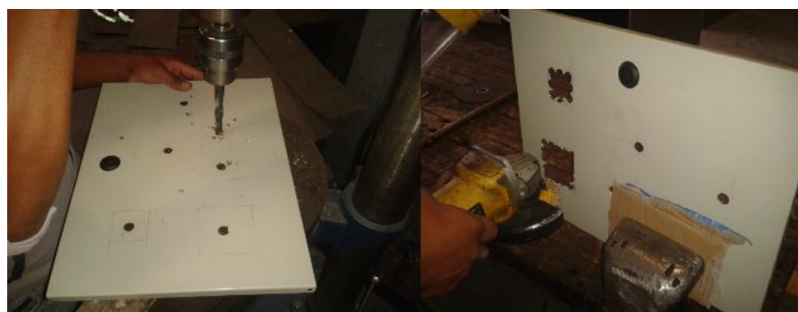
Figura 3. 10: Adaptación de los elementos de control en el tablero. (Aguirre/Sánchez, Tablero de control 2013)
