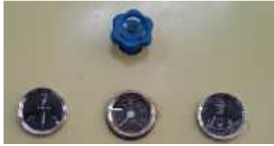
Figura 7. 10 Llaves de paso de las líneas del sistema de refrigeración
