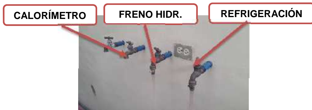
Figura 7. 6 Llaves de paso de agua a los sistemas del banco de pruebas
