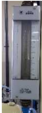
Figura 3. 53 Medidor de flujo de agua de gases de escape
