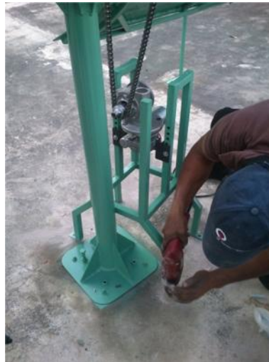
Figura 106 Base para el motor eléctrico
