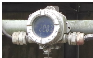
Figura 7. Transmisor de temperatura.
