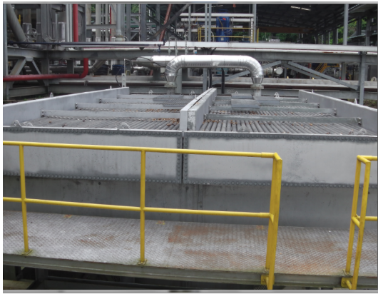
Figura 12. Aero Enfriador WS16-EX1-002 A/B (Similar al que se va a implementar) .
