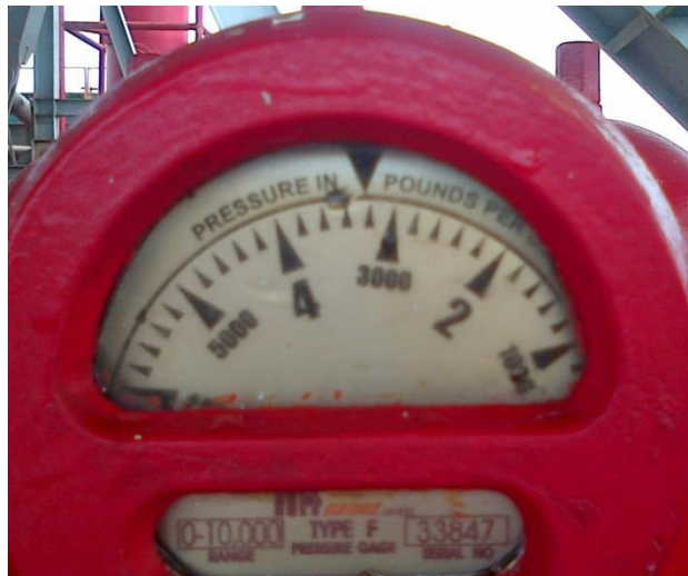
Figura 2.31. Manómetro del Manifold de distribución, CPV-23.
