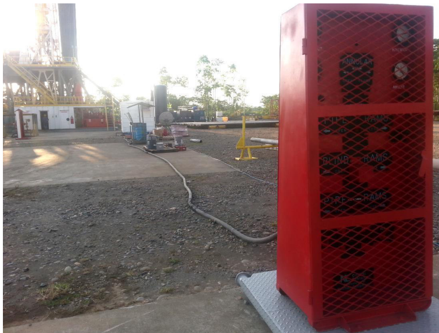
Figura 2.45. Distancia de ubicación del panel remoto desde el Acumulador de Presión locación 2 (60m aprox.).
