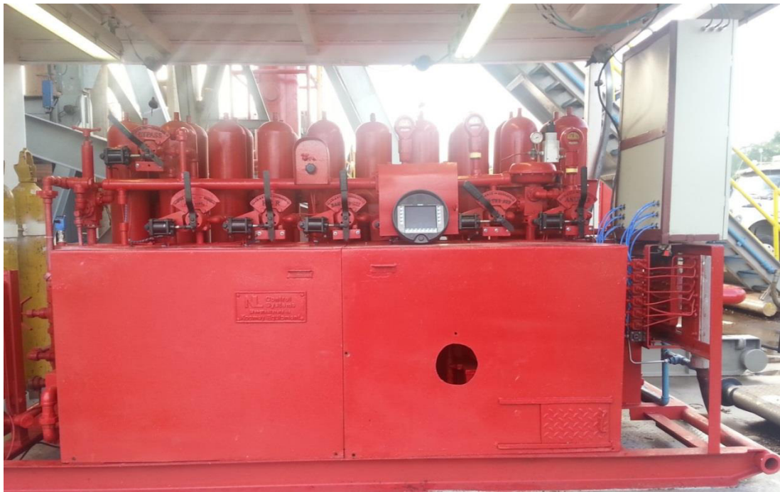
Figura 4.66. Instalación final del Acumulador de Presión.
