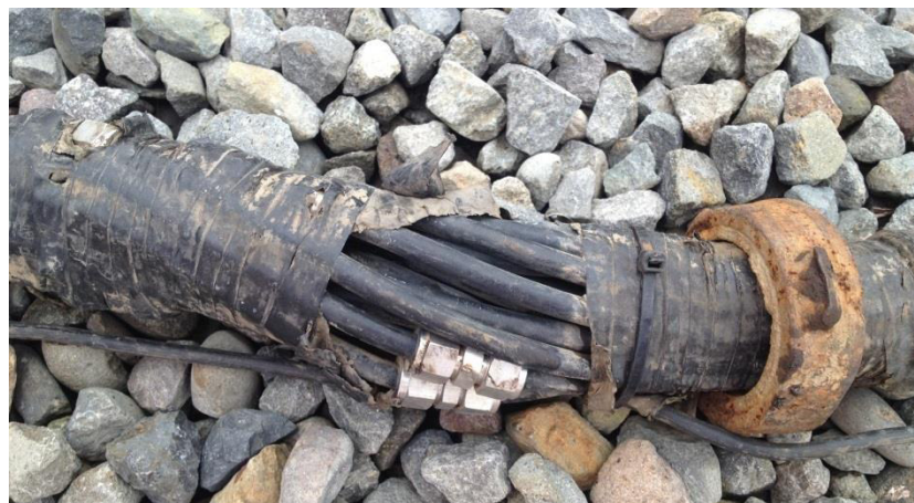
Figura 2.46. Mal estado de mangueras de señales del control remoto.
