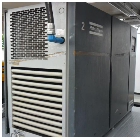
Figura 3.15. Compresor ATLAS COPCO GA+55
