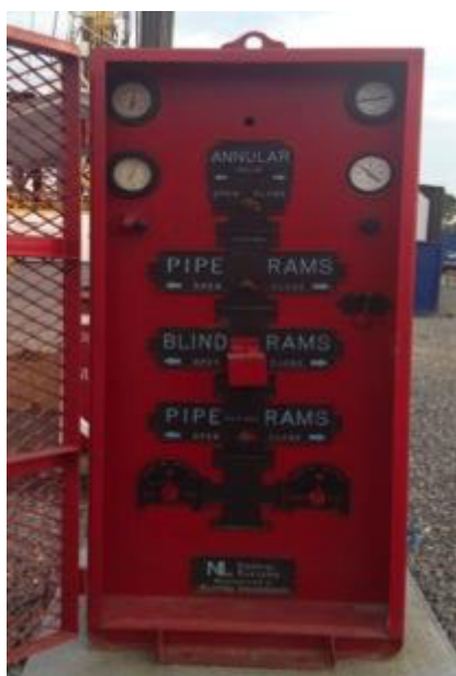
Figura 1.2. Panel remoto de control del acumulador de presión
