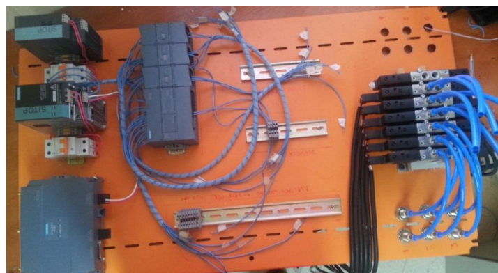
Figura 4.20. Organización de cableado de control.
