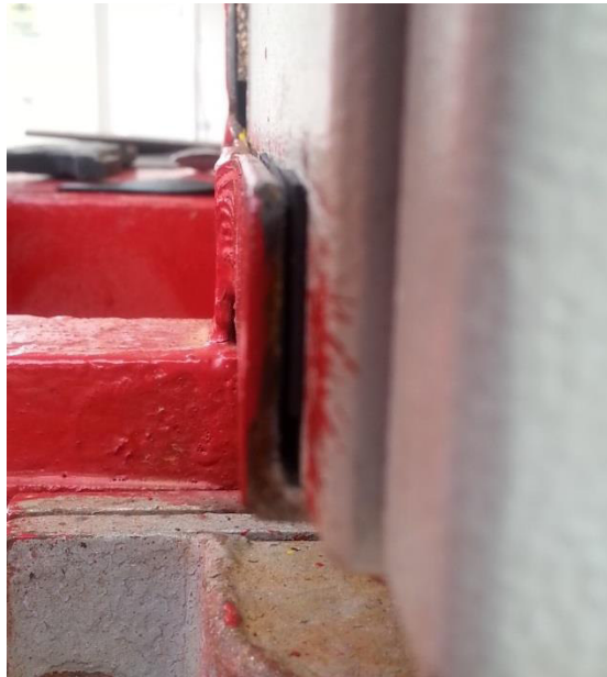
Figura 4.5. Aisladores inferiores del gabinete del acumulador de presión
