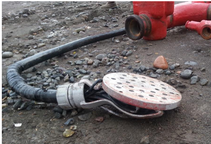
Figura 2.47. Aplastamiento y rotura de plato de terminales neumáticas por un camión montacargas.
