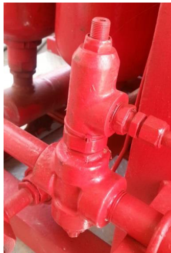
Figura 2.40. Válvula de seguridad del manifold de distribución, CPV-23.
