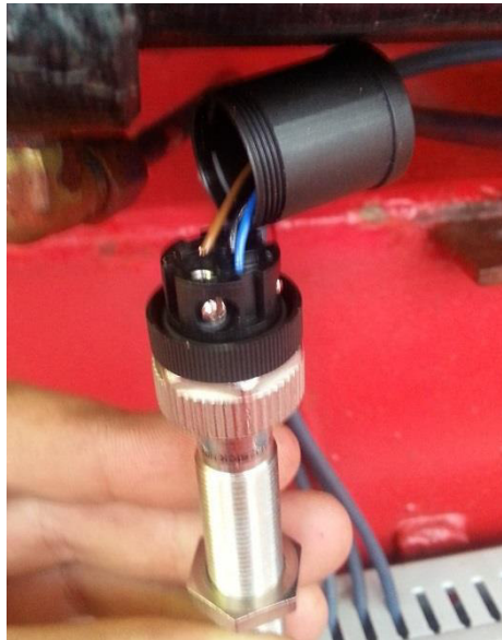
Figura 4.22. Conexión de cableado de sensores inductivos
