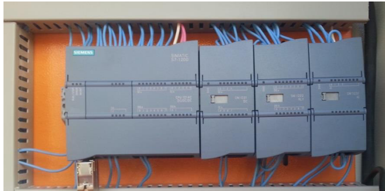
Figura 4.31. Conexión del cableado del PLC
