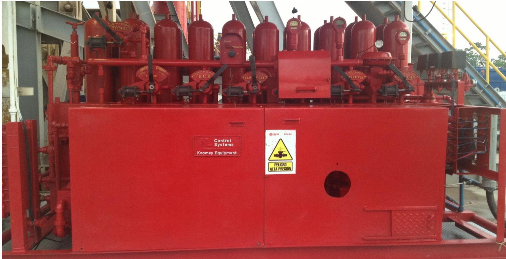
Figura 2.41. Unidad acumulador de presión, CPV-23
