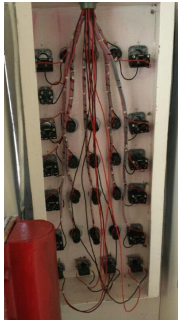
Figura 4.40. Conexión de luces piloto y pulsadores del panel eléctrico.
