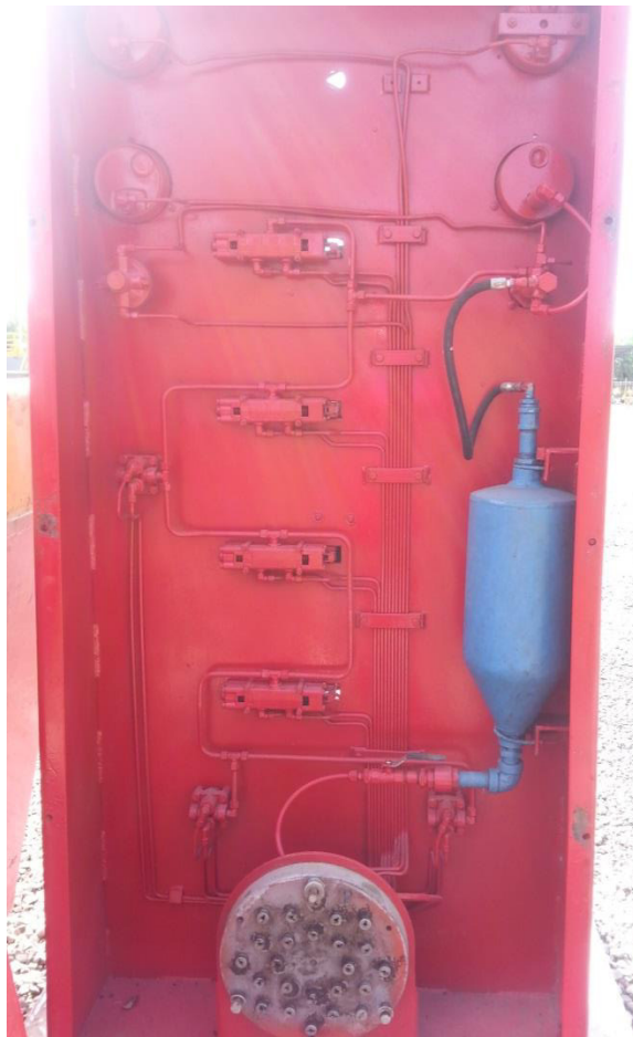
Figura 2.16. Panel remoto original (vista interior).
