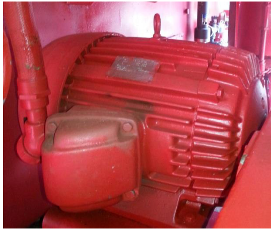
Figura 2.25. Motor eléctrico del acumulador de presión, CPV-23.
