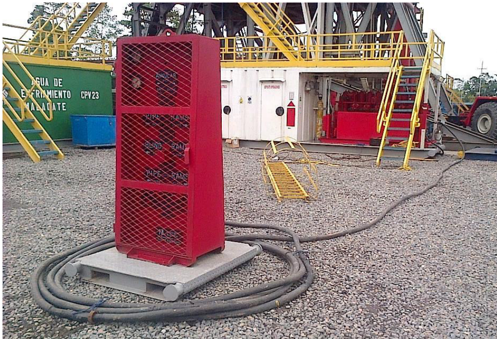
Figura 2.44. Distancia de ubicación del panel remoto desde el Acumulador de Presión locación 1 (30m aprox.).
