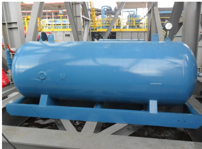
Figura 3.17. Reservorio 5000lt Lado Perforador
