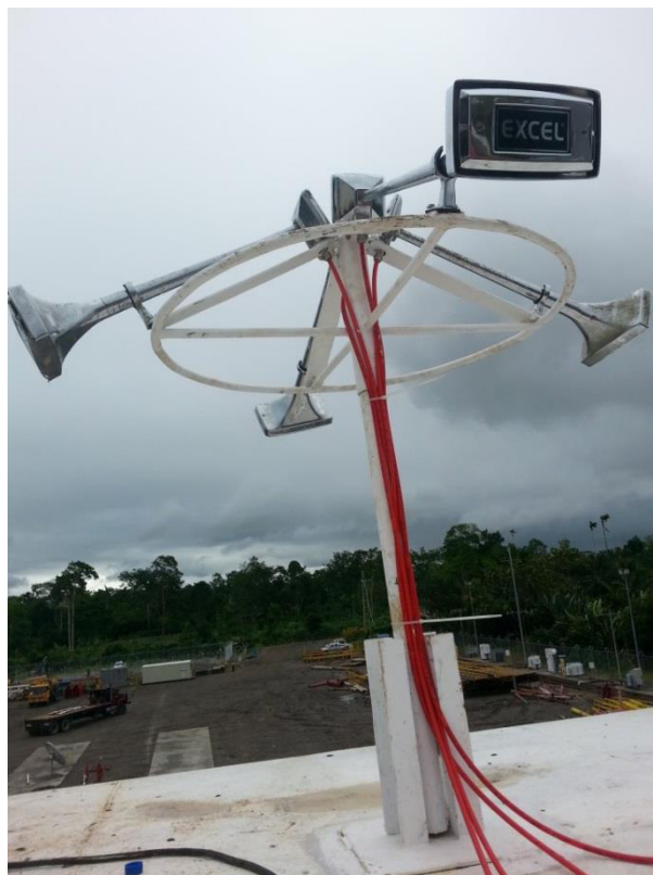
Figura 4.45. Cornetas instaladas en soporte.
