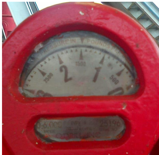
Figura 2.29. Manómetro del sistema acumulador, CPV-23.
