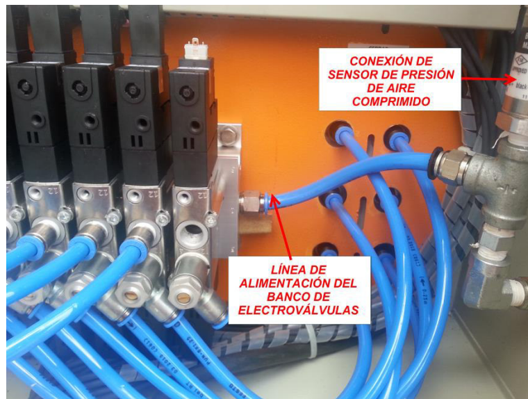
Figura 4.12. Conexión de sensor de aire comprimido y banco de electroválvulas.
