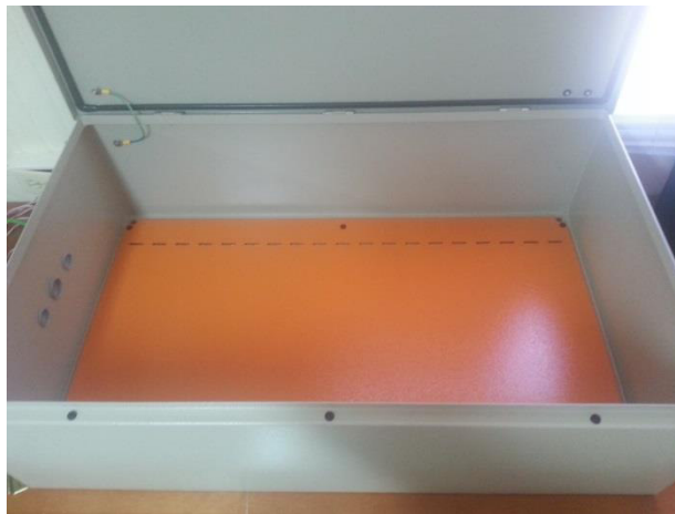
Figura 4.2. Gabinete del acumulador de presión
