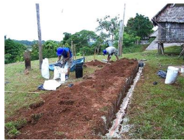
Fig. 6. Pozo de puesta a tierra
