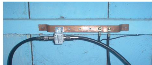
Fig. 7. Protector de línea instalado en barra máster
