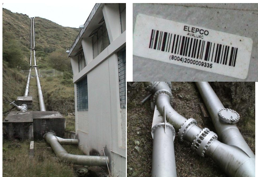
Figura 2.2: Tuberías de la Central Illuchi N° 2 hacia la Casa de Máquinas
