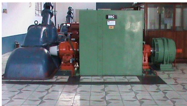
Figura 2.6: Grupo de Generación G1 de la Central Illuchi N° 2
