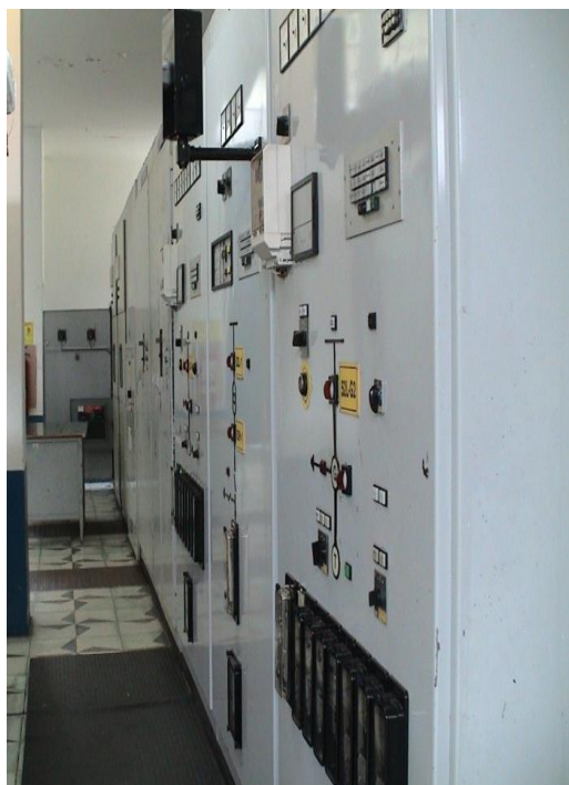
Figura 2.11: Tablero de control para los grupos y S/E central Illuchi N° 2
