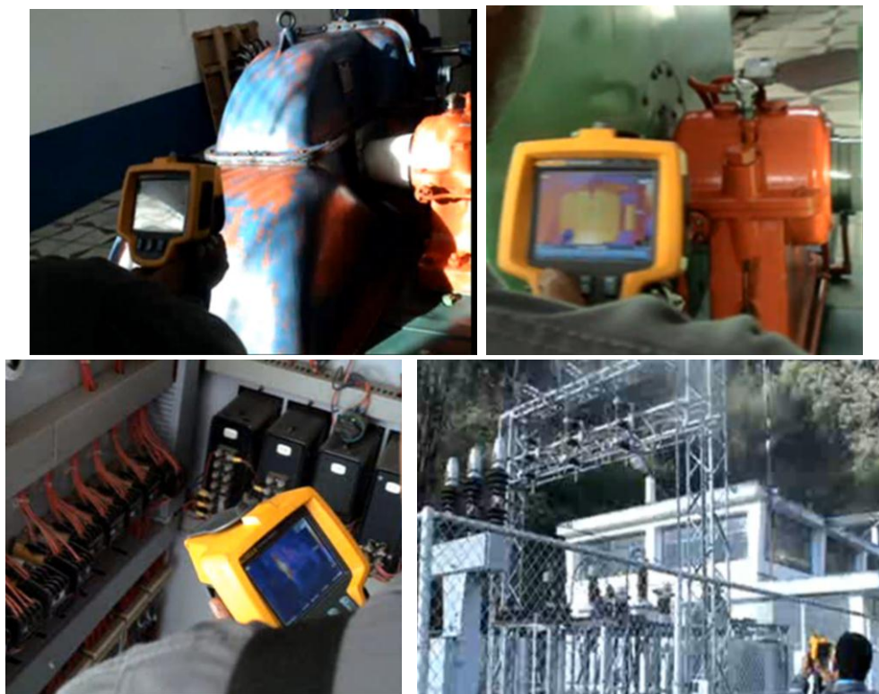
Figura 4.12 Fotografía de pruebas termografías
