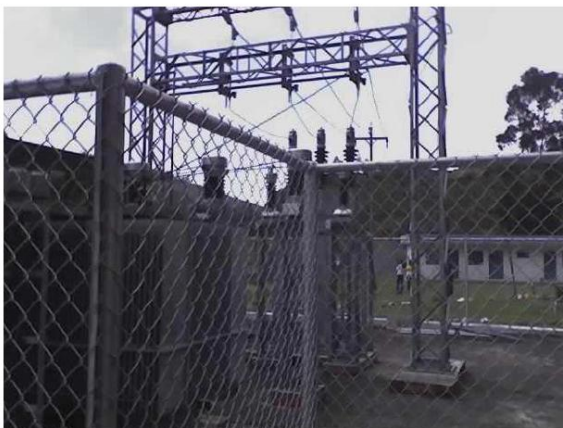
Figura 2.16. Subestación de la Central Illuchi 2
