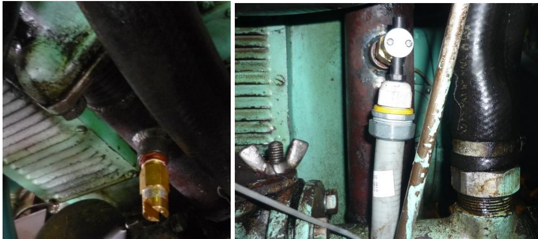
Fotografía. 5. 3. Instalación de switch de Flujo en la tubería de descarga de lodos.
