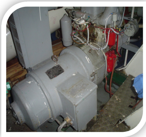
Figura 2 Generador de Emergencia
