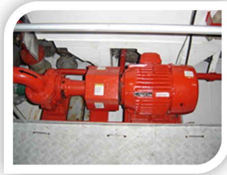
Figura 22 Bomba contra incendio
