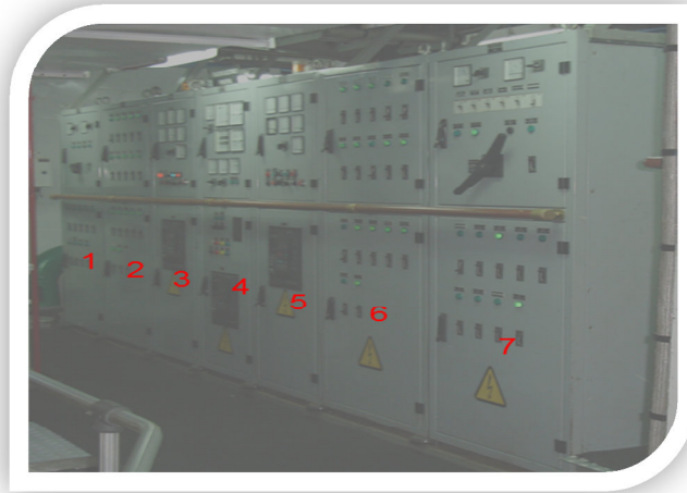
Figura 14 Tableros de Distribución Eléctrica
