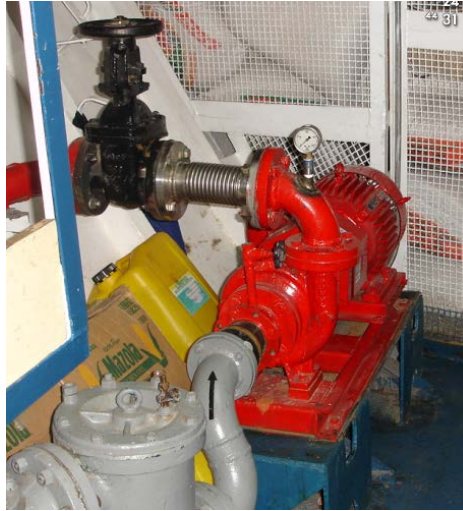
Figura 1.17 Bomba Contra Incendio
