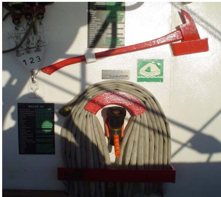
Figura 1.20 Estación Contra Incendio
