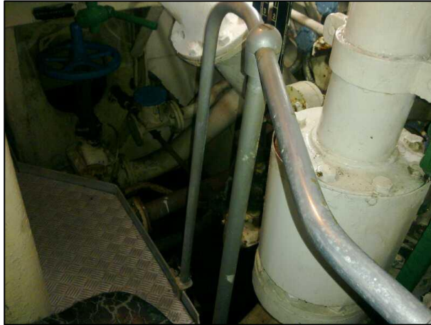
Figura4Sala de máquinas
