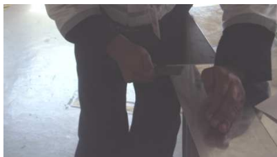
Figura 4.106. Limado y lijado de los bordes de la lámina que corto. Fuente: Investigación de campo. Editado por: Luis Calderón.
