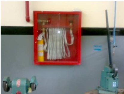
Manguera contra incendios
