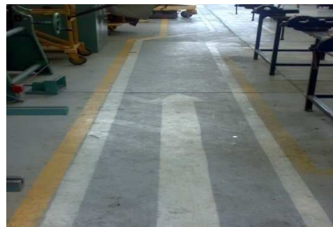
Señalización de tránsito
