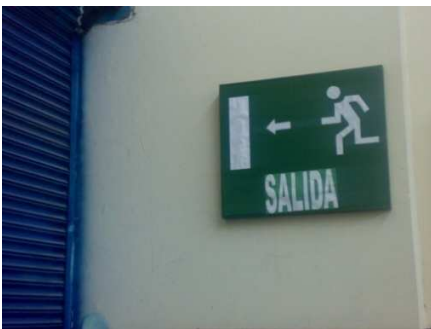
Letrero de salida de emergencia
