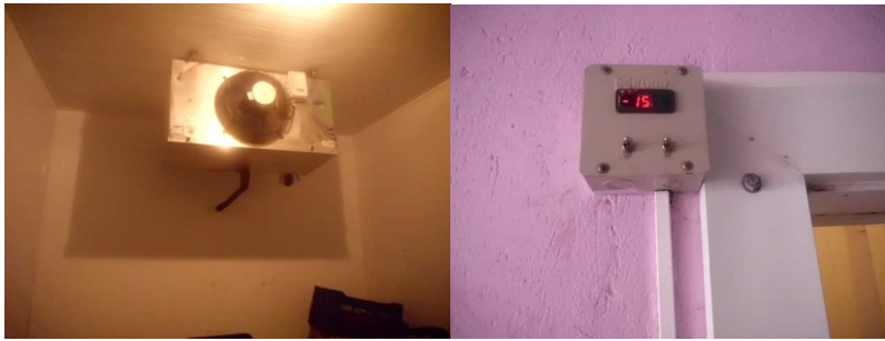
Ventilador de cuarto frío
