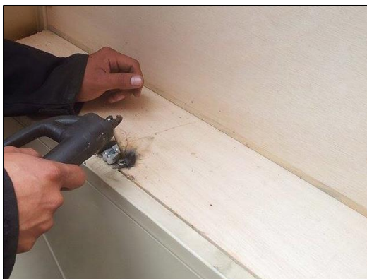
Figura 3. 22 Soporte de los elementos eléctricos carga y descarga.
