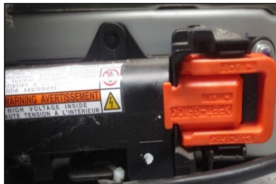
Figura 4. 16 Jumper de seguridad.
