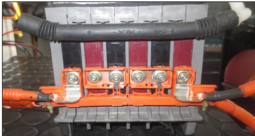
Figura 4. 39 Ubicación de las chapas metálicas y sus cables.
