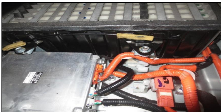
Figura 4. 40 Conexión de cables de monitoreo en la ECU de la batería HV.
