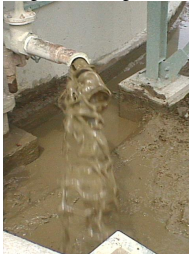
Fotografía 8.5 Purga de lodos
