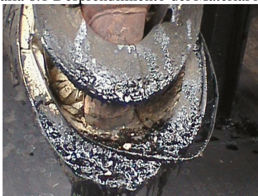
Fotografía 8.1 Desprendimiento del Material Aislante
