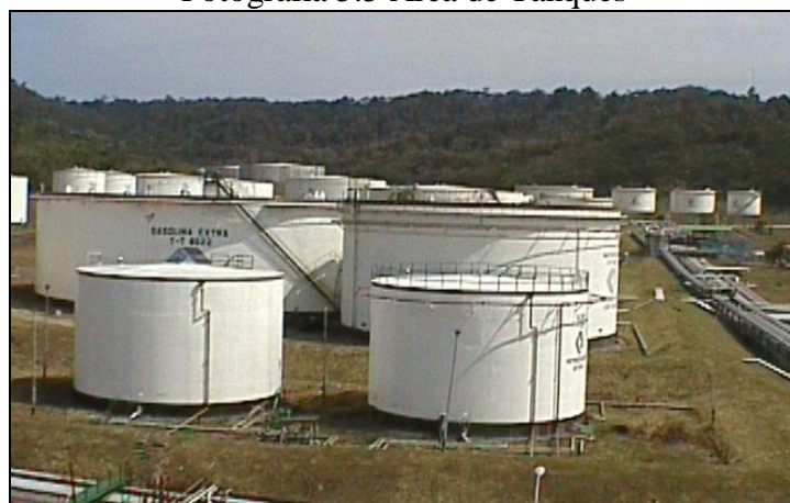
Fotografía 5.5 Área de Tanques
