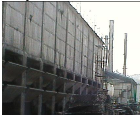
Fotografía 5.8 Torres de Enfriamiento
