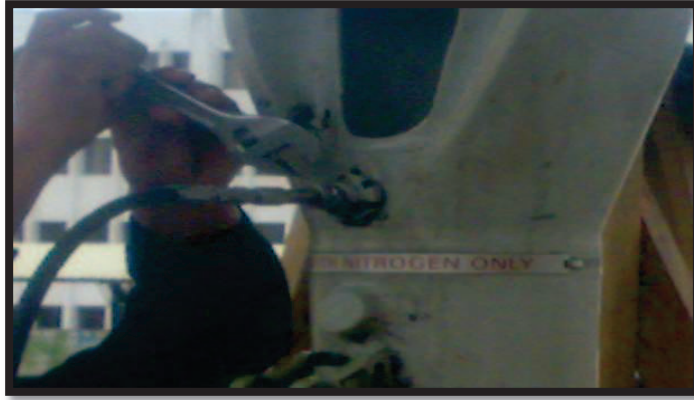
Figura: 3.40. Conexión de la cañería de nitrógeno con válvula de llenado
