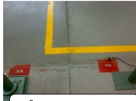
SEÑALIZACION DE LOS TOMA CORRIENTE.
