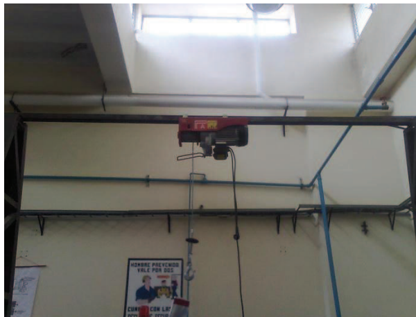
Figura 3.11. Motor en la estructura
