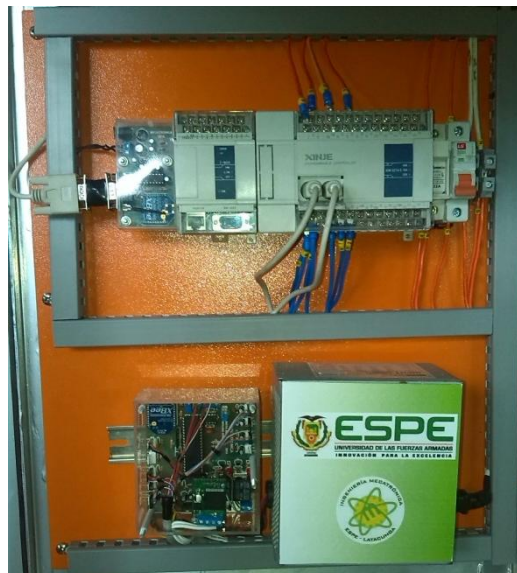
Figura 3.28: Tablero de control.
