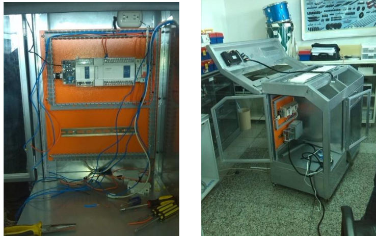
Figura 3.27: Cableado del tablero de control.
