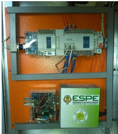
Figura 4.1: Tablero de control de la estación didáctica.
