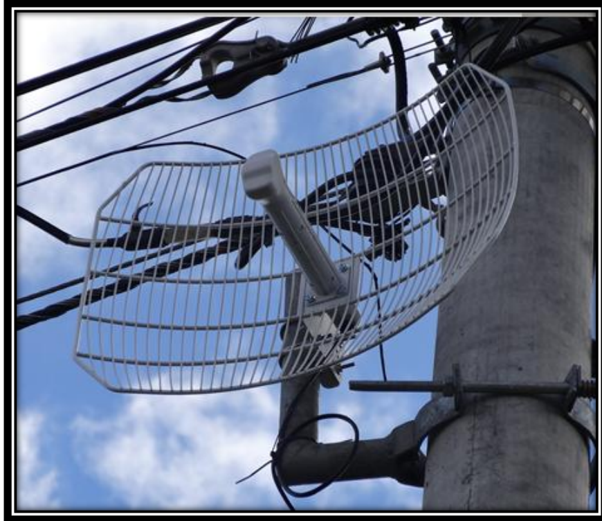
Figura 3.15 Disposición del radio AirMax de Ubiquiti Network direccionado hacia la estación repetidora Tanque 1
