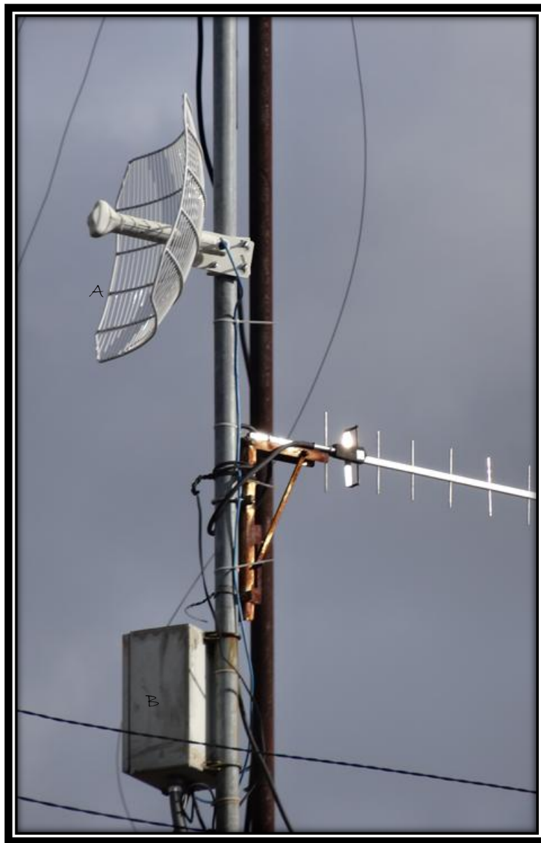
Figura 3.19 Disposición del COE ELEPCO S.A. El Calvario, A: Ubicación del radio AirMax de Ubiquiti Network direccionado hacia la estación remota Tanque1, antena direccional 23dBi B: Gabinete de conexiones eléctricas ya existente en la Subestación de Distribución Eléctrica EL Calvario
