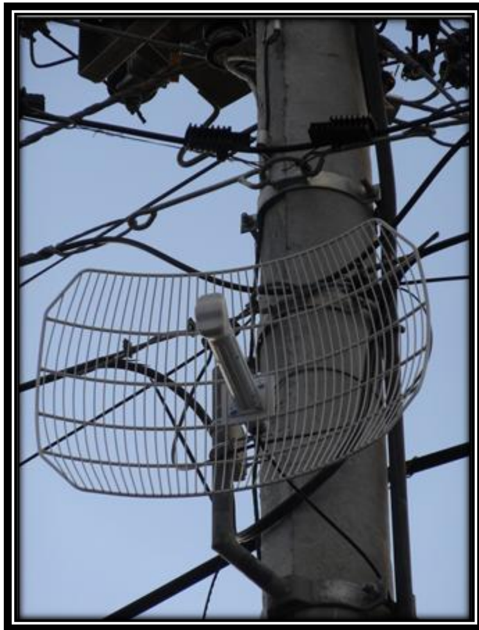
Figura 3.11 Disposición del radio AirMax de Ubiquiti Network direccionado hacia la estación repetidora Tandalivi
