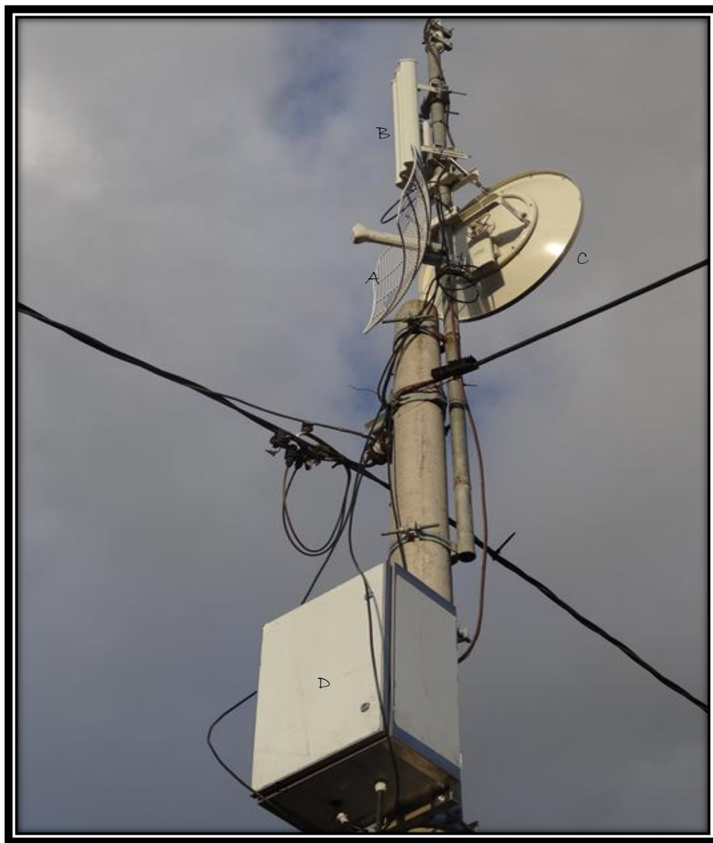
Figura 3.17 A: Disposición del radio AirMax de Ubiquiti Network direccionado hacia la estación remota Piedra Colorada, antena direccional 23dBi B: Disposición del radio Rocket de Ubiquiti Network direccionado hacia la subestación de distribución eléctrica Mulalo, antena incorporada 28dBi C: Disposición del radio Bullet de Ubiquiti Network direccionado hacia la estación repetidora Tanque 1, antena parabólica 32dBi D: Gabinete de conexiones eléctricas
