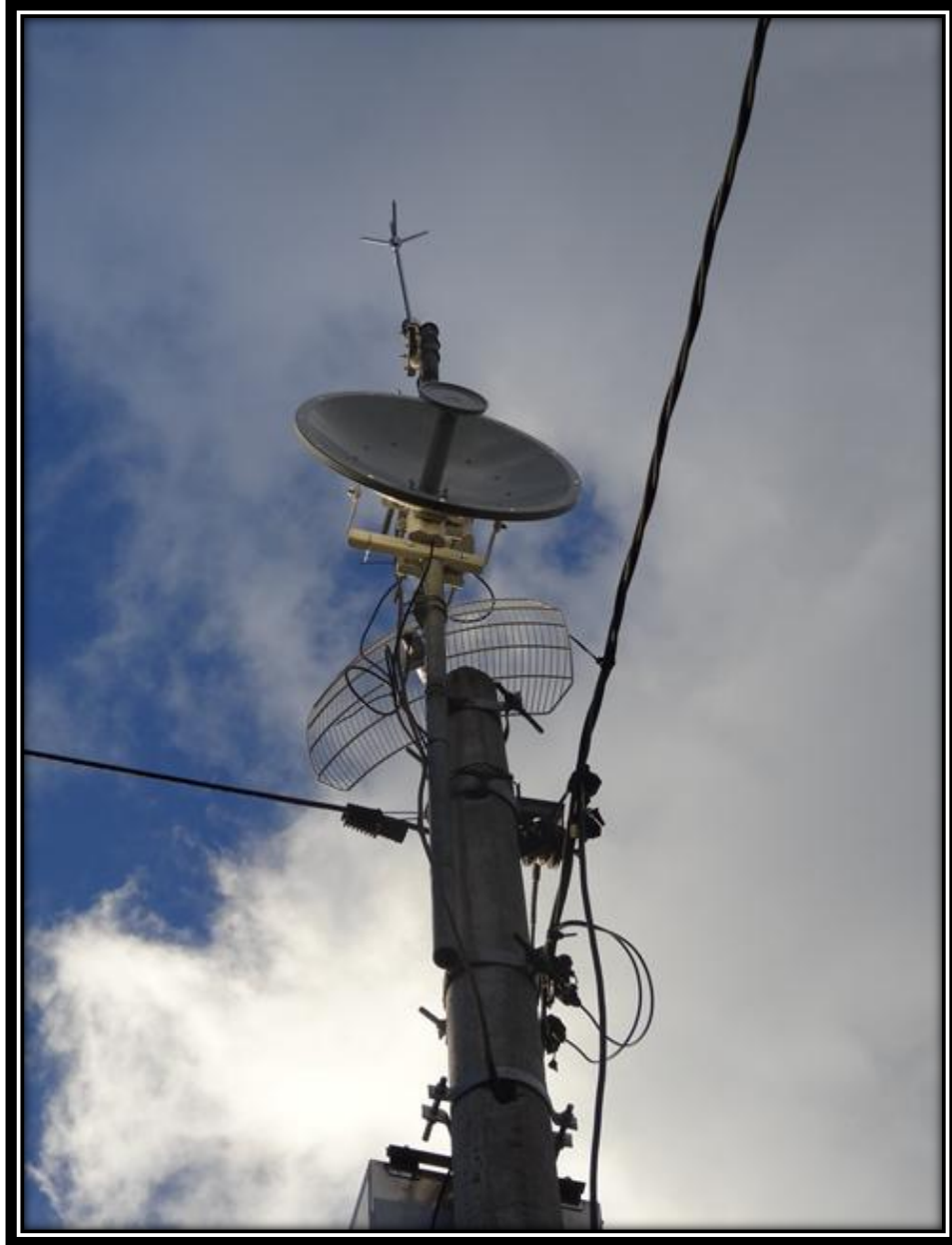
Figura 3.18 Sistema de Puesta a Tierra utilizando Punta Franklin – Estación Repetidora Tandalivi.
