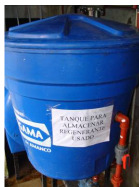
Figura 8.13. Tanque para almacenar regenerante usado, Capacidad 100L.
