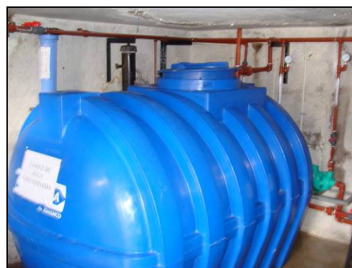
Figura 8.4. Tanque de almacenamiento de agua cruda, Capacidad 2000L.
