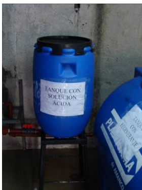
Figura 8.14. Tanque para almacenar solución ácida Capacidad 50L.
