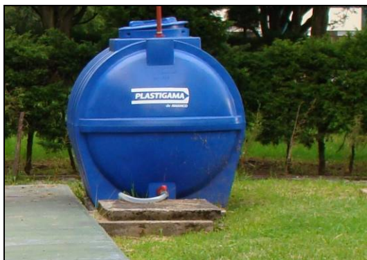
Figura 8.5. Tanque de almacenamiento de agua cruda exterior, Capacidad 2000L.
