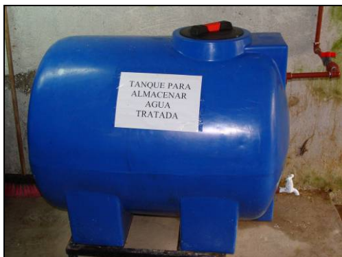
Figura 8.11. Tanque de almacenamiento de agua tratada, Capacidad 250L.
