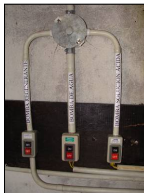
Figura 8.6. Cajas de encendido.
