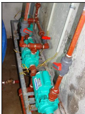
Figura 8.7. Bombas de 0,25 HP de potencia.
