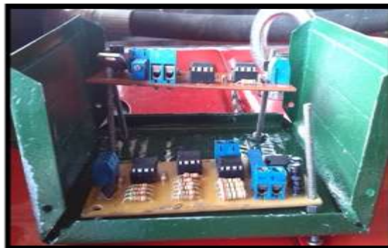
Figura 4.11 Caja de circuitos electrónicos (sensores de nivel).
