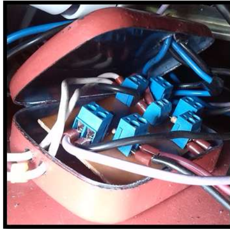
Figura 4.12 Caja de circuitos eléctricos.
