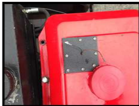
Figura 4.3 Implementación de la base del sensor de nivel de combustible.
