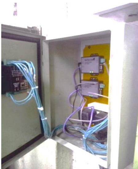
Figura N° 3.10 Conexión convertidor RS-485 al medidor DATAKOM 409
