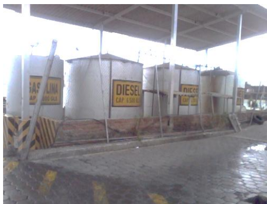
Figura N°. 2.9 Almacenamiento y Distribución de Combustible
