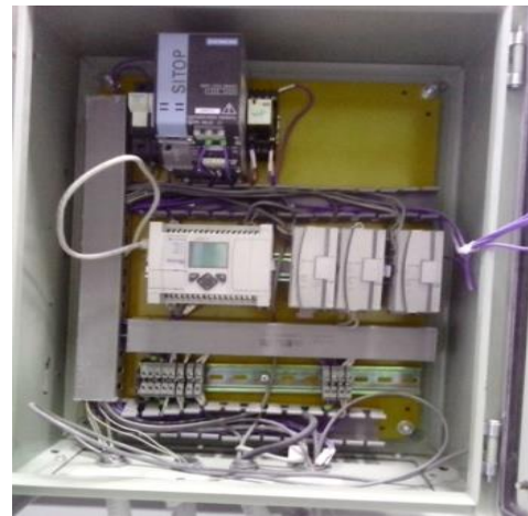
Figura N° 3 Implementación PLC área pintura
