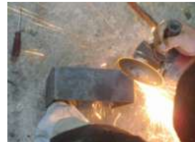
Figura 29 Corte de la capsulas que alojan a las mesas del sistema de suspensión
