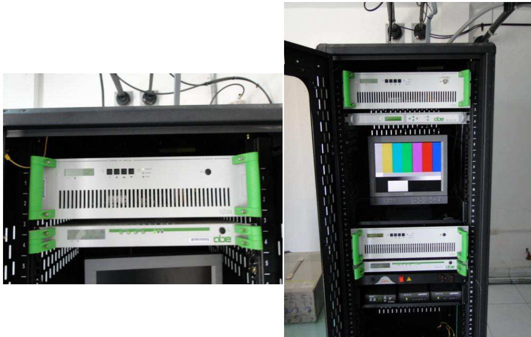
Figura. 5.40. Cuarto de Equipos Microondas de ESPOL TV
