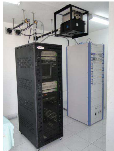
Figura. 5.42. Cuarto de Equipos Capaes
