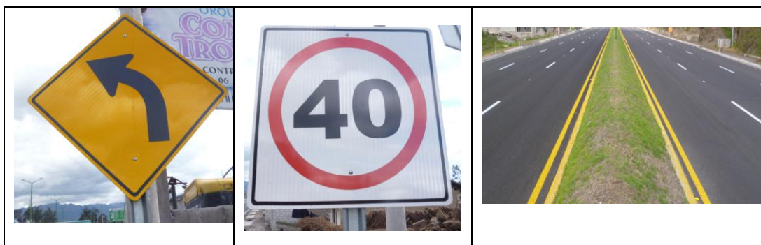
Figura 5.20 Estado Actual de las Señales de Tránsito Autovía "Otavalo-Ibarra"
