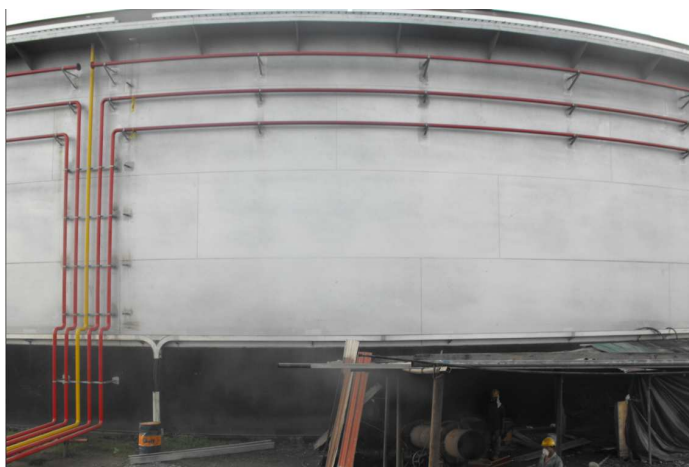
Figura 2.4.- Sistema Contra Incendios [10]
