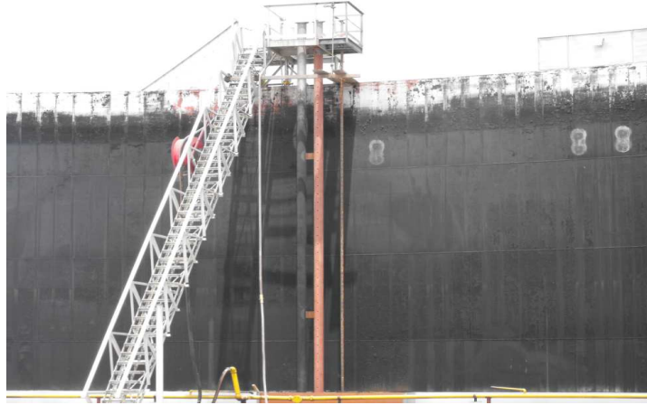
Figura 2.12.- Tubo de Aforo [18]
