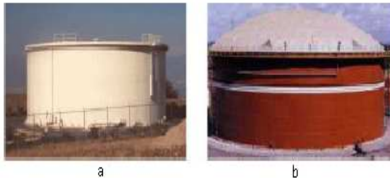
Figura 2.2.- Tanques de Techo Flotante (a) Externo ; (b) Interno [8]
