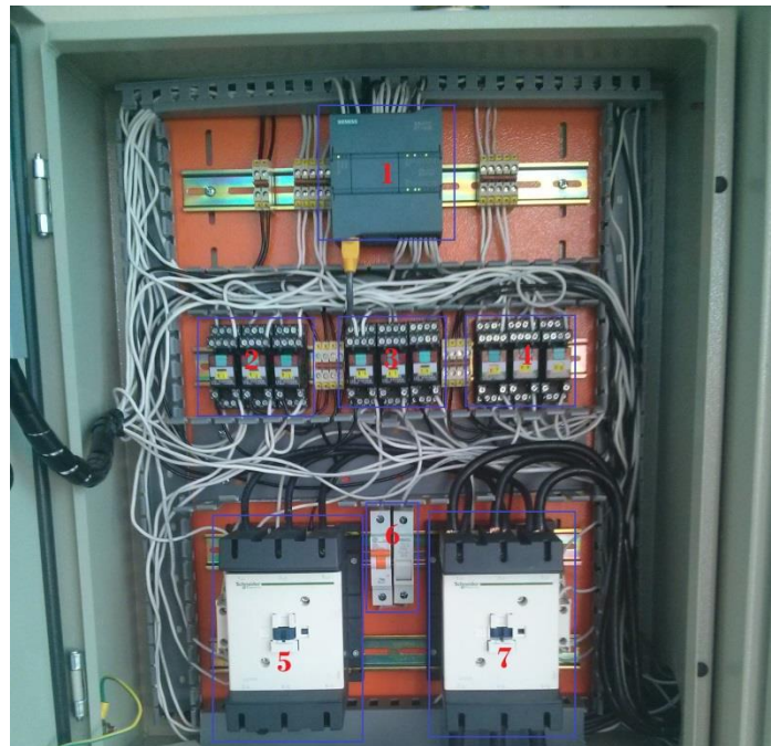
Figura 3. 19 Elementos del tablero de transferencia.
