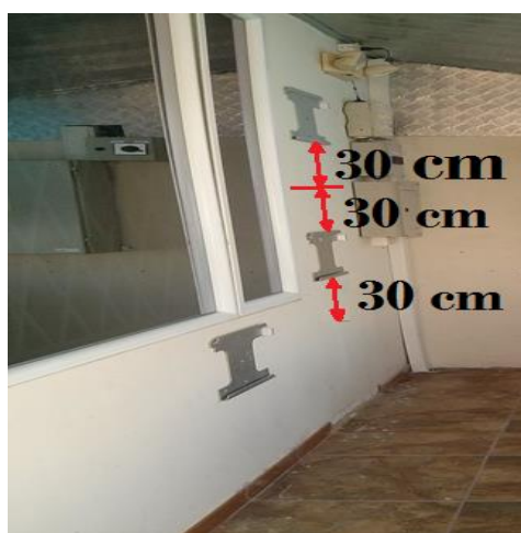
Figura 3. 6 Soporte para los inversores.
