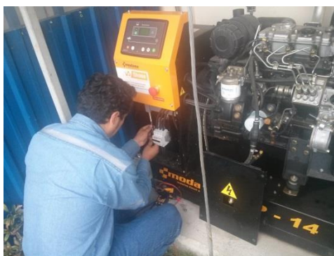
Figura 4. 9 Ajuste de frecuencia en el grupo electrógeno.
