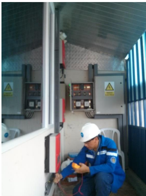
Figura 4. 3 Toma de parámetros en los inversores.
