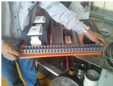
Figura 3. 18 Distribución de elementos en el tablero de transferencia.
