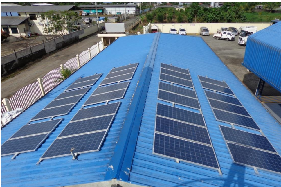
Figura 3. 9 Distribución de los paneles solares en la cubierta de las oficinas.
