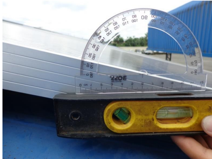
Figura 4. 7 Inclinación de los paneles solares.
