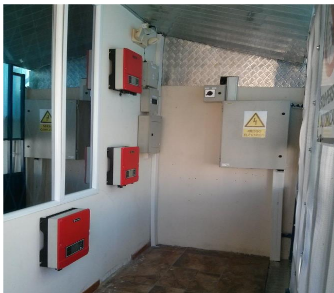
Figura 3. 7 Sujeción de los inversores.
