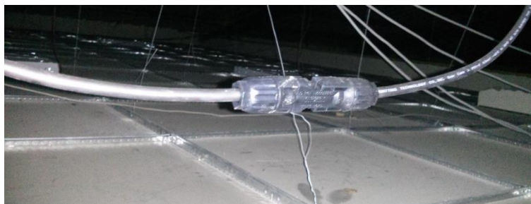
Figura 3. 11 Conexión interna entre módulos fotovoltaicos.
