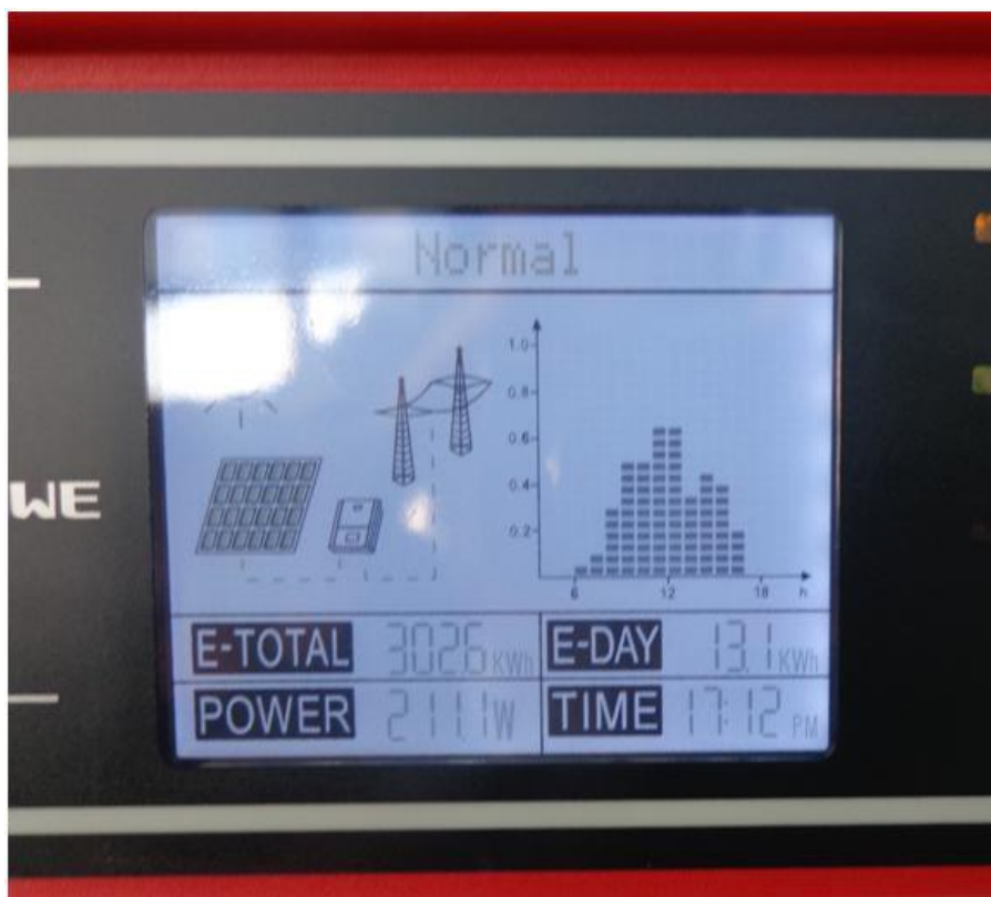
Figura 4. 5 Toma de parámetros del Inversor A al mes de la instalación del sistema.
