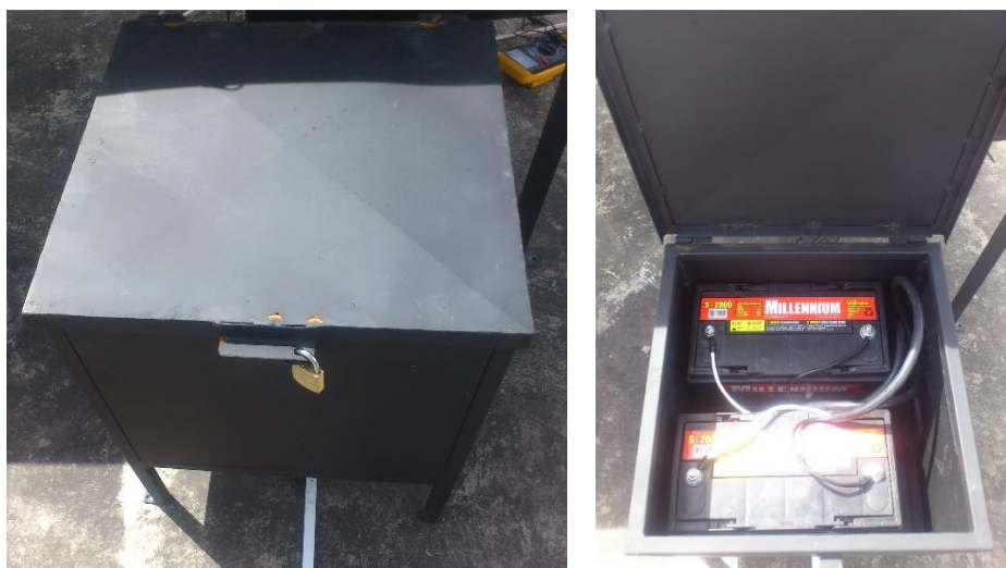
Figura 4.5 Almacenamiento de baterías
