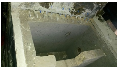
Figura 12. Cámara de postcombustión
