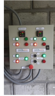
Figura 19. Tablero de control del crematorio de animales domésticos
