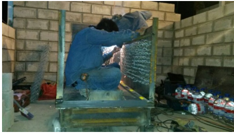
Figura 10. Paredes metálicas para soporte de refractario
