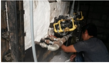
Figura 16. Aislamiento térmico en la zona de quemadores
