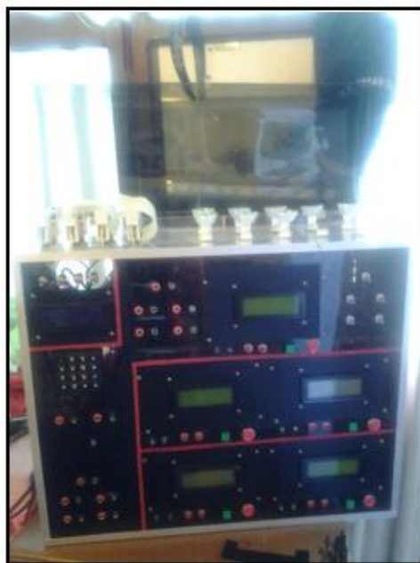
Figura 4.36. Cargador automatizado de baterías HV Realizado por: Ávila, Erazo, Quiroz
