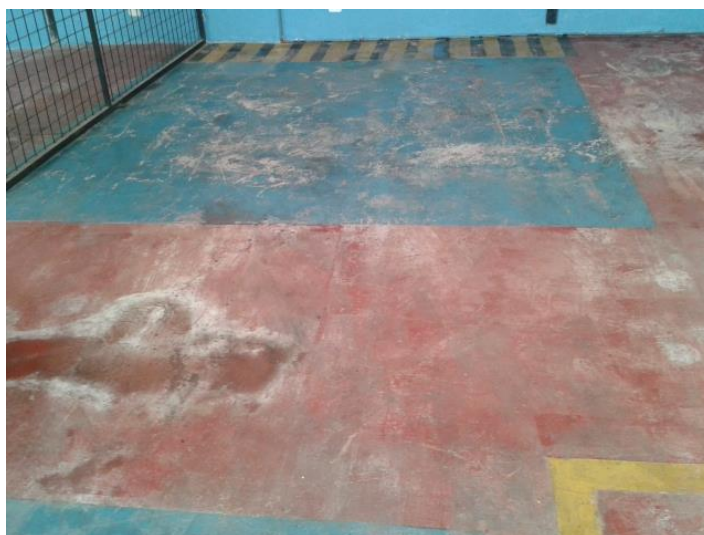
Gráfico No. 14: Piso en mal estado.
