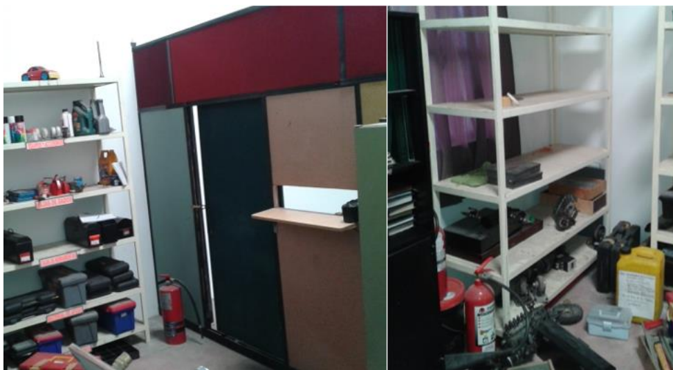
Gráfico No. 38: Ubicación incorrecta de equipos de extinción de incendios.
