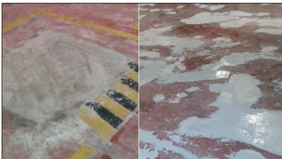
Gráfico No. 72: cubrimiento de agujeros y grietas.
