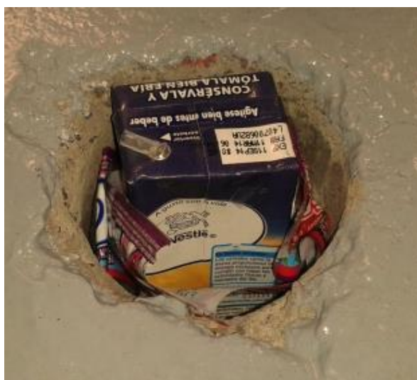
Gráfico No. 30: Cañería de desagüe tapada.
