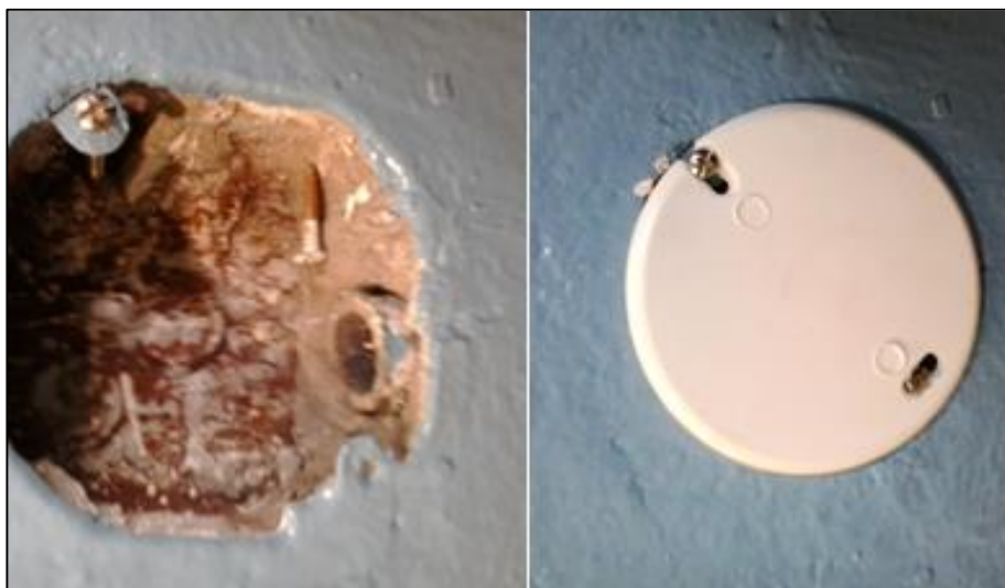
Gráfico No. 79: Colocación tapas faltantes.
