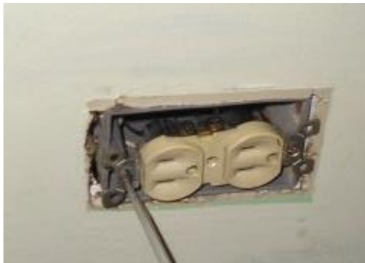
Gráfico No. 18: Tomacorrientes incompletos.
