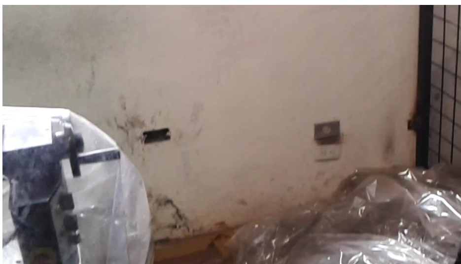
Gráfico No. 17: Cableado expuesto.
