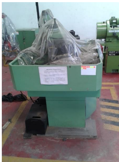
Gráfico No. 19: Cableado de maquinaria mal ubicado COMEC RP 330.
