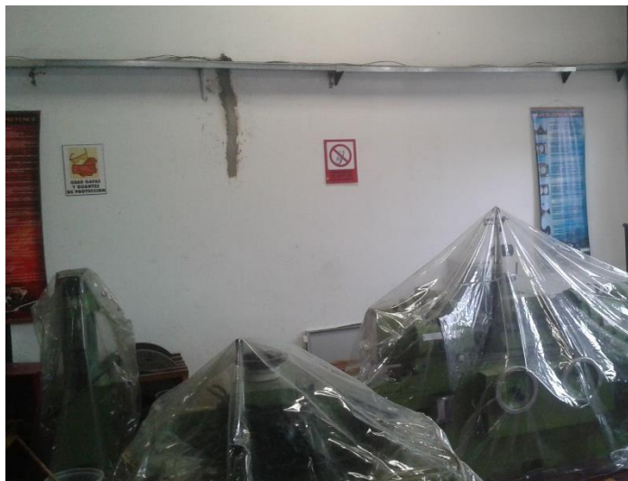
Gráfico No. 13: Reparaciones inadecuadas de paredes.
