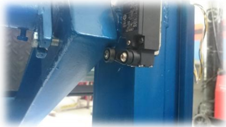
Figura No. 33: Instalación del sensor final de carrera Elaborado por: Pozo E. y Puma D.
