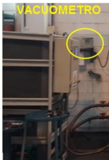
Figura 5.8. Vacuómetro instalado. Elaborado por: Orozco Ruíz, Héctor Hugo
