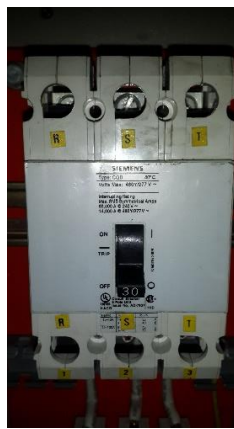
Figura 7. Interruptor principal. Elaborado por: Orozco Ruíz, Héctor Hugo
