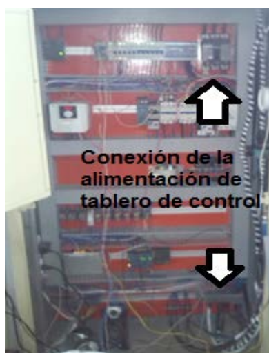
FIGURA 3.3. Alimentación del Tablero de Control Eléctrico. ELABORADO POR: Arroba, P. y López, J.
