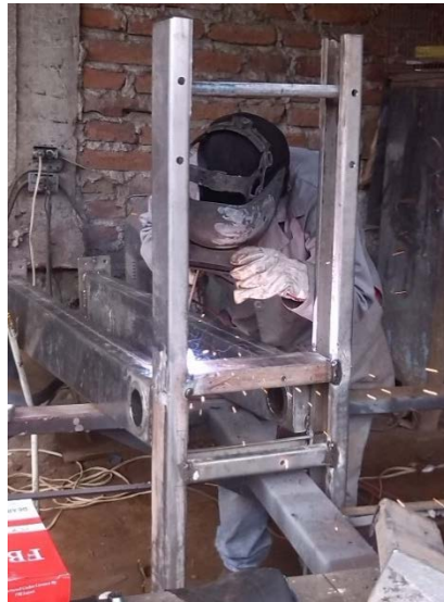
FIGURA 3.33. Soldadura de la base izquierda y derecha. ELABORADO POR: Arroba, P. y López, J.
