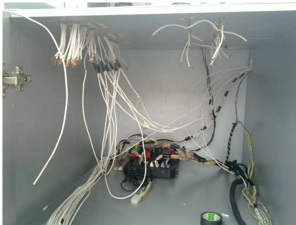
Gráfico No. 3.54: Cableado interno para pruebas.
