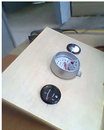
Gráfico No. 3.43: Instalación de medidores.
