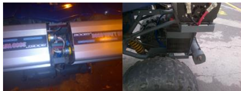
Figura 3.11 Conexión de cables (motores reductores, inversores y batería)
