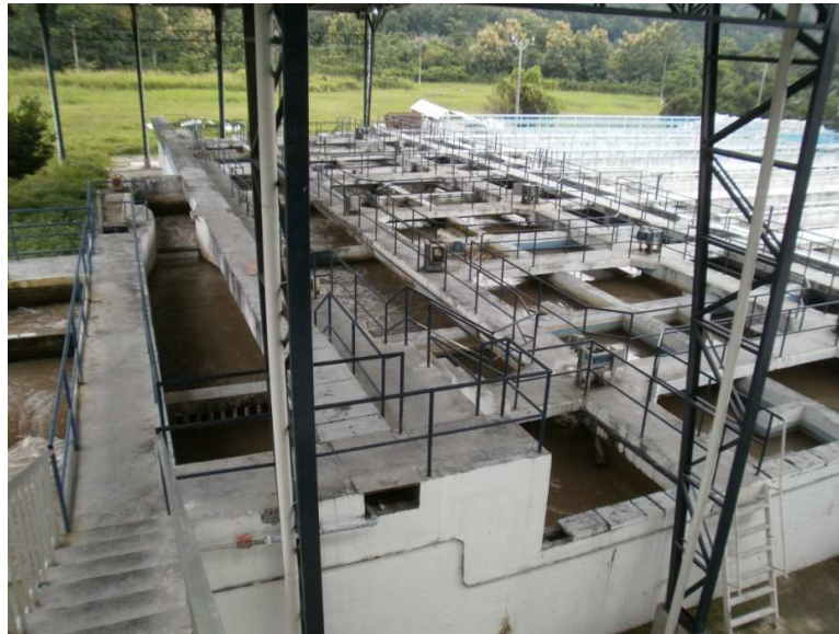
Figura 14. Llegada del agua al módulo de potabilización.
