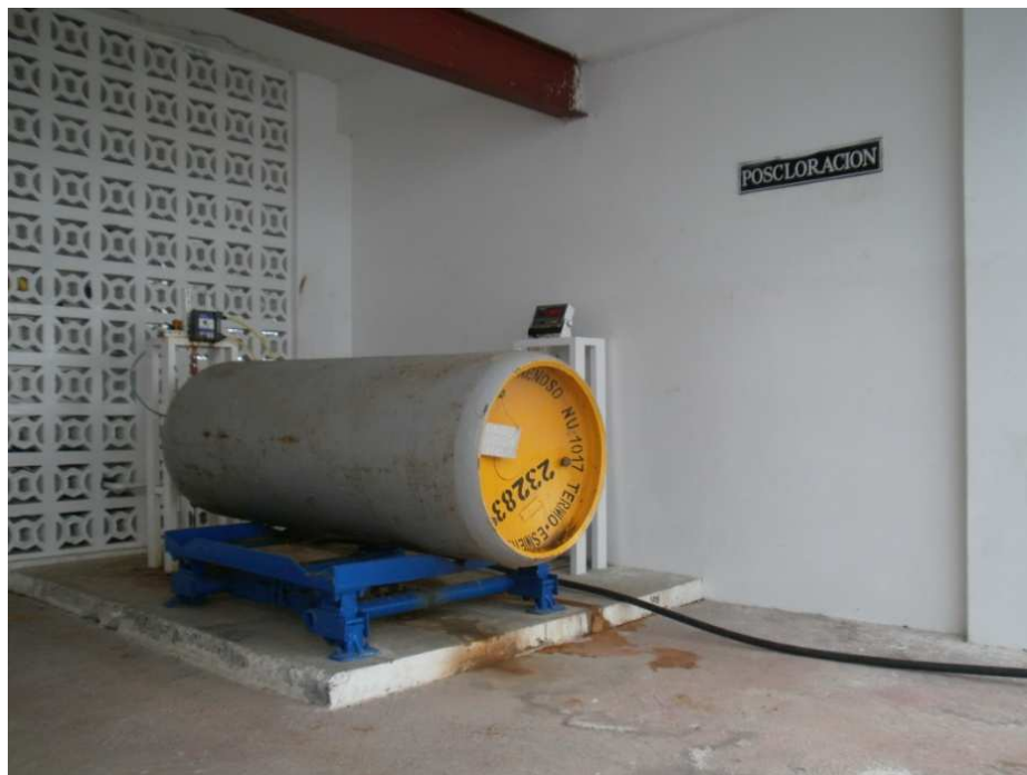
Figura 16. Dosificación de cloro a la salida del módulo de potabilización.
