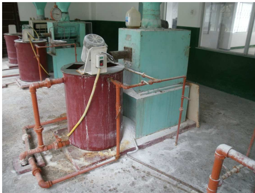
Figura 15. Dosificación de sulfato de aluminio.
