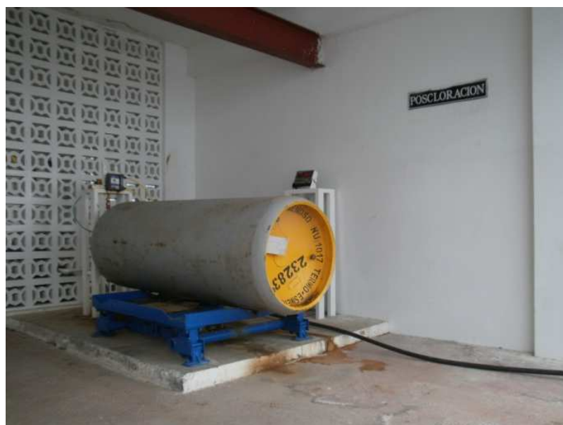
Figura 3. Cilindro que contiene cloro gas, sin un cubeto respectivo.
