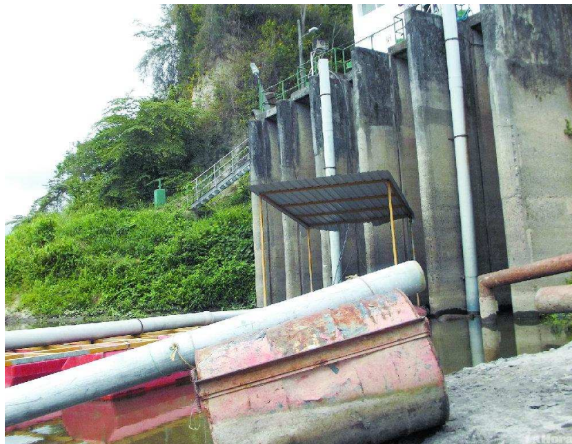
Figura 10. Captación del agua desde el río Esmeraldas
