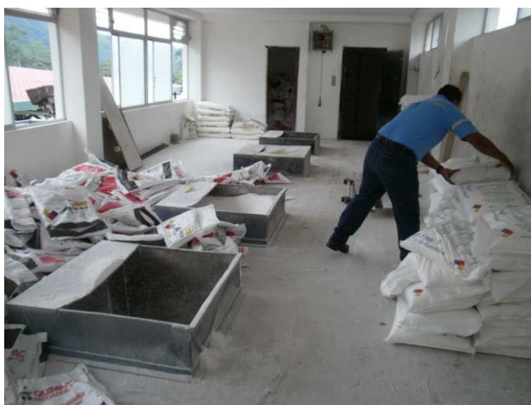
Figura 5. Torva de dosificación de sulfato de aluminio y cal.
