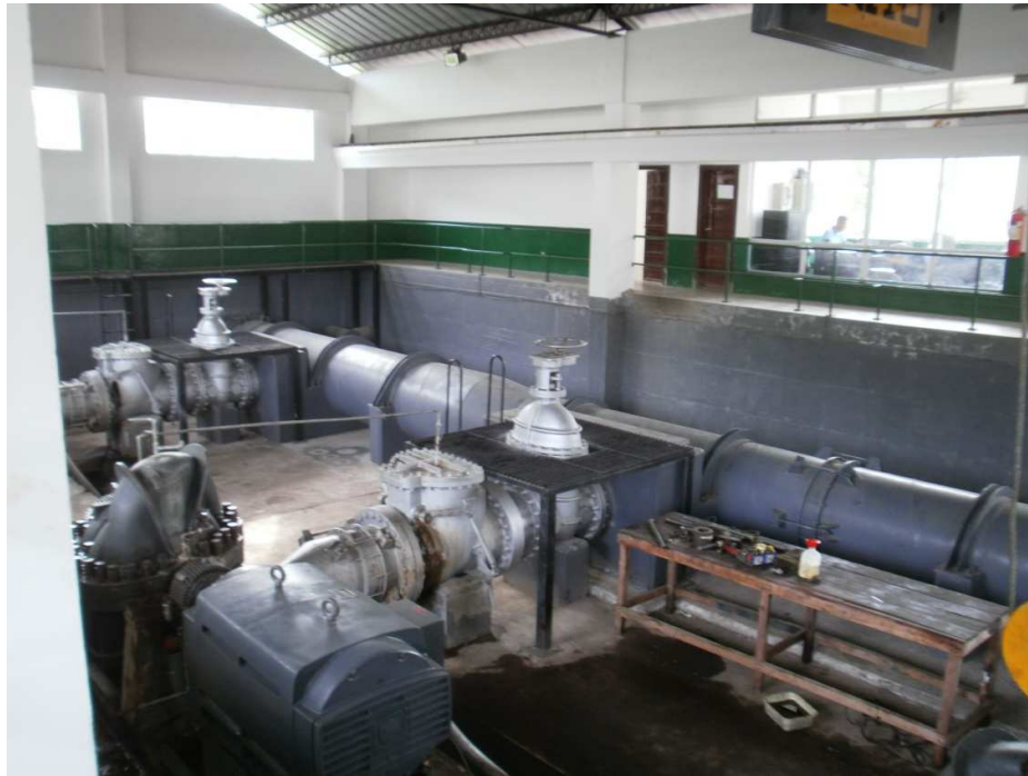
Figura 18. Tubería de bombeo de agua tratada.
