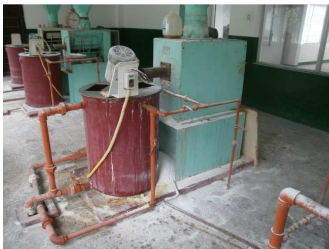
Figura 4. Dosificación de Sulfato de aluminio y cal en el tanque de mezcla.
