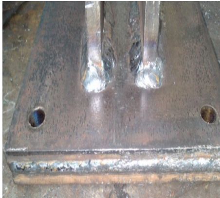
Figura 5.20: Planchas de anclaje al piso
