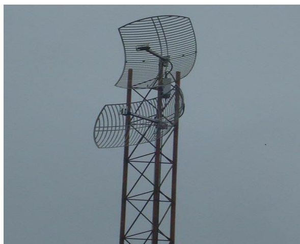
Ilustración 1 Equipos instalados para dar el servicio de internet a las escuelas
