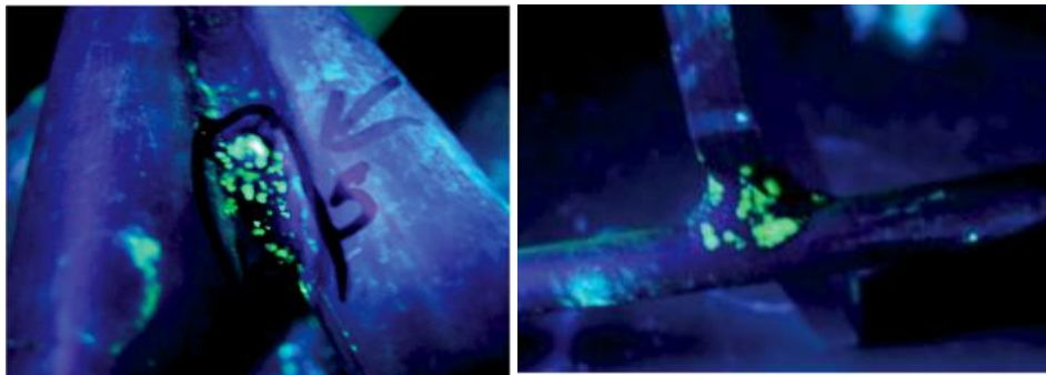
Figura 171. Indicación de porosidades producidas por líquido penetrante fluorescente
