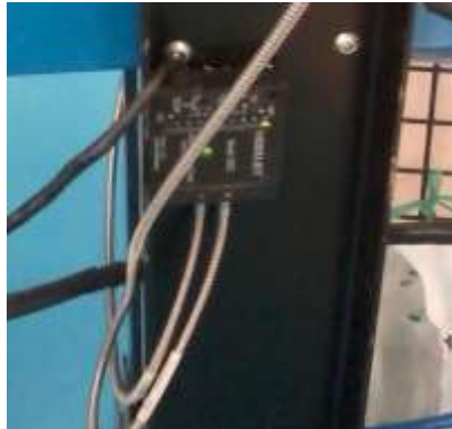
Figura 3. 17. Conexión de sensor fotoeléctrico al tablero principal
