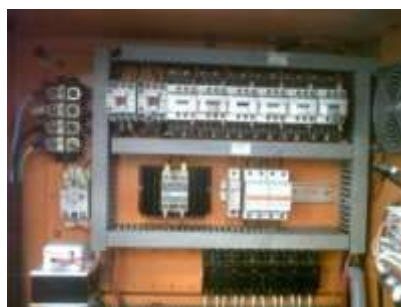
Figura 3. 4. Conexión de termocuplas y resistencias al tablero principal
