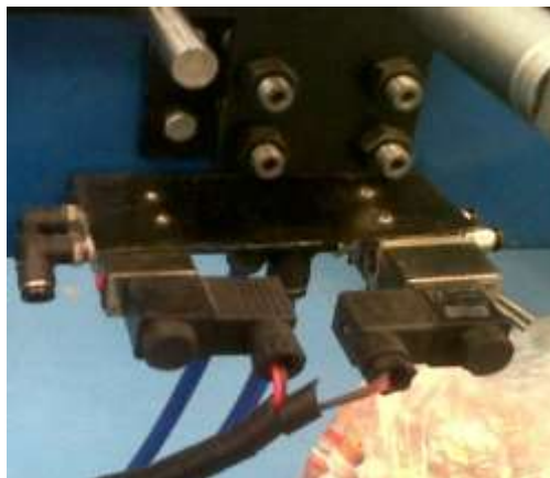
Figura 3. 16. Conexión de electroválvulas al tablero principal
