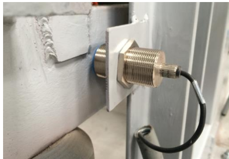
Ilustración 198: Sensor de proximidad IM30-10BPO-ZC1 instalado
